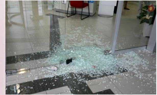
Rotura de vidrios
